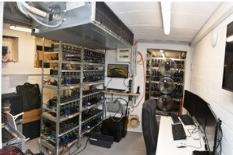
Foto: Polizei Münster (Das Foto zeigt einen Serverraum) Veröffentlichung mit dieser Pressemitteilung honorarfrei.
