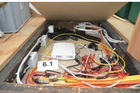
Foto: Polizei Münster (Das Foto zeigt Verkabelungen in einer Zwischendecke) Veröffentlichung mit dieser Pressemitteilung honorarfrei.
